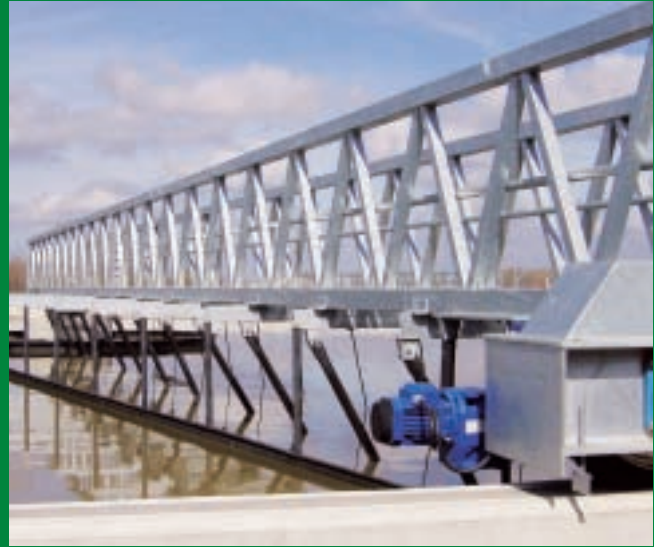
Depuradora de aguas residuales. Salamanca
