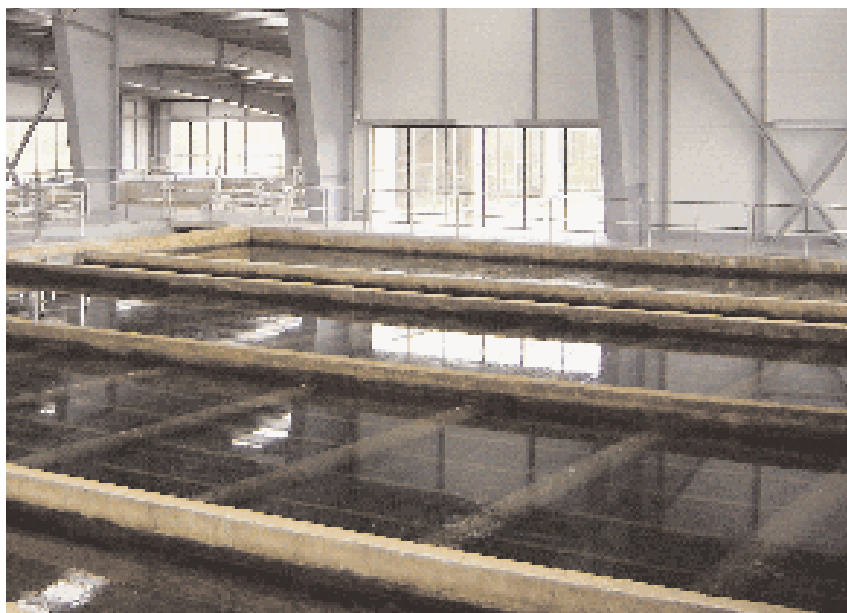
Estación de tratamiento de agua potable. Burgos
