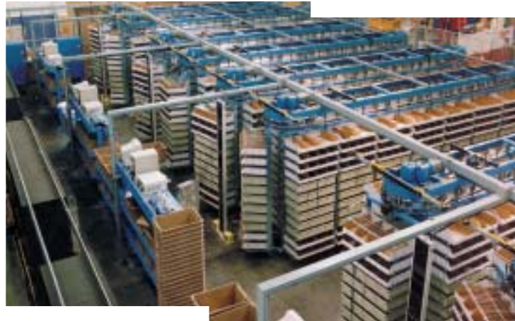
Instalaciones automáticas de picking.
