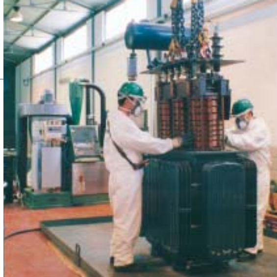
Gestión de transformadores contaminados.
