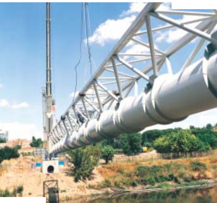
Interconexión entre las cuencas del Jarama-Lozoya y Alberche. Guadarrama (Madrid). Acueducto sobre el Manzanares.
