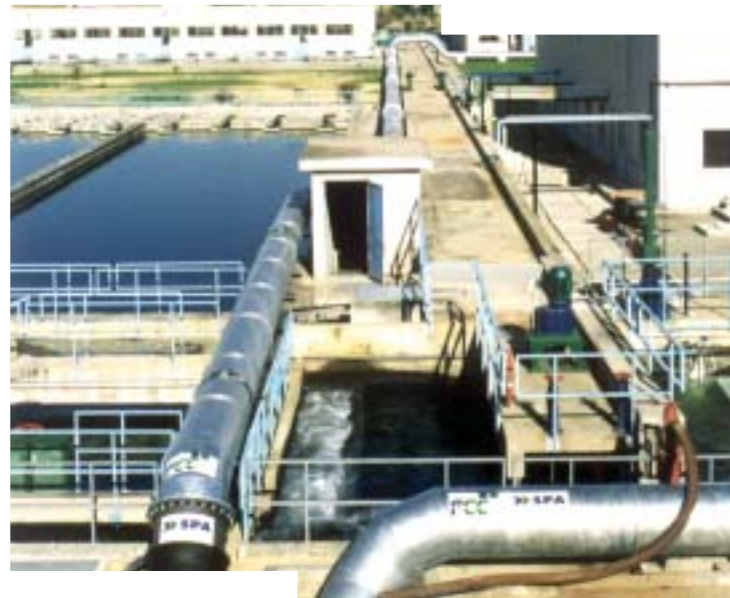
Estación depuradora de aguas residuales de El Espinar. San Rafael (Segovia).
