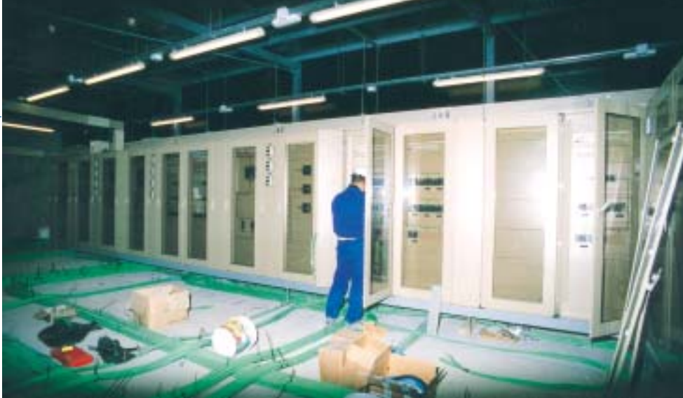
Instalaciones eléctricas del edificio Sogecable. Madrid.
