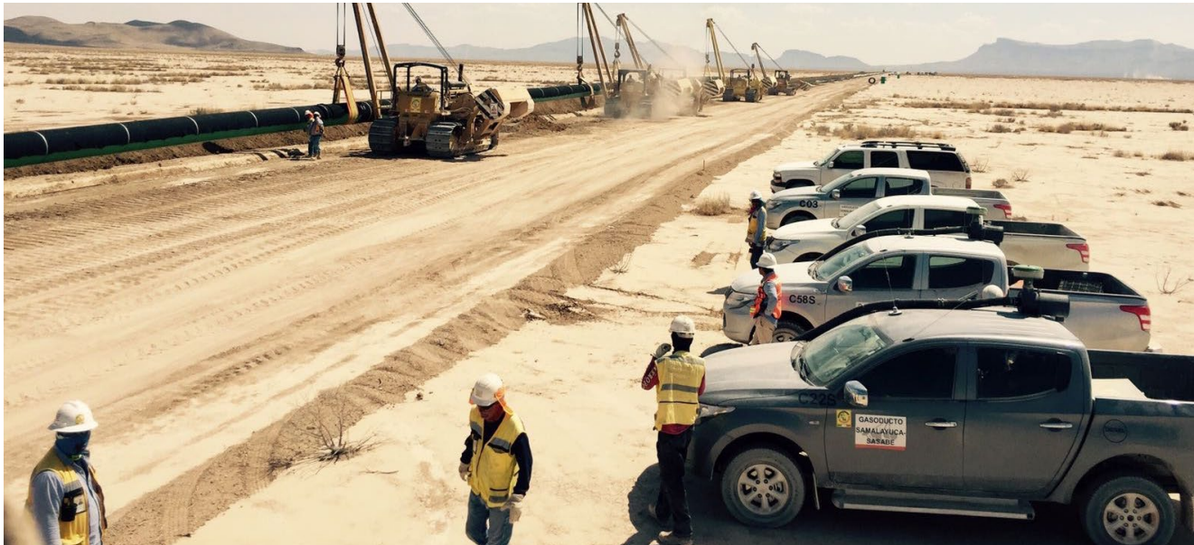
Gasoducto Samalayuca. Sásabe, México.
