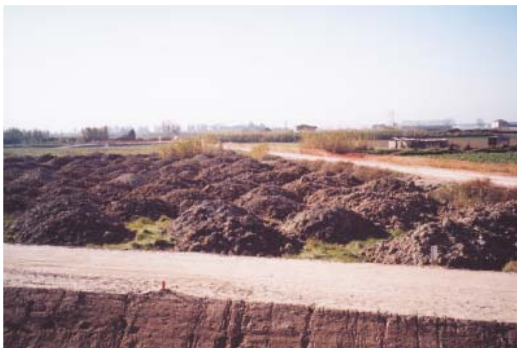
La tierra vegetal debe separarse convenientemente para su posterior reutilización en labores de restauración. En ocasiones, además, es preciso diferenciar distintos tipos y calidades para conseguir una adecuada reposición de la situación anterior, lo que lleva a marcar las áreas de generación y los acopios de acuerdo con sus características
