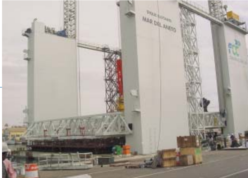
La prefabricación de determinados elementos fuera del medio natural en que se enclavan finalmente supone la reducción de riesgos de contaminación por accidente o incluso del mismo proceso constructivo, como la prefabricación de cajones de hormigón para muelles portuarios en diques flotantes
