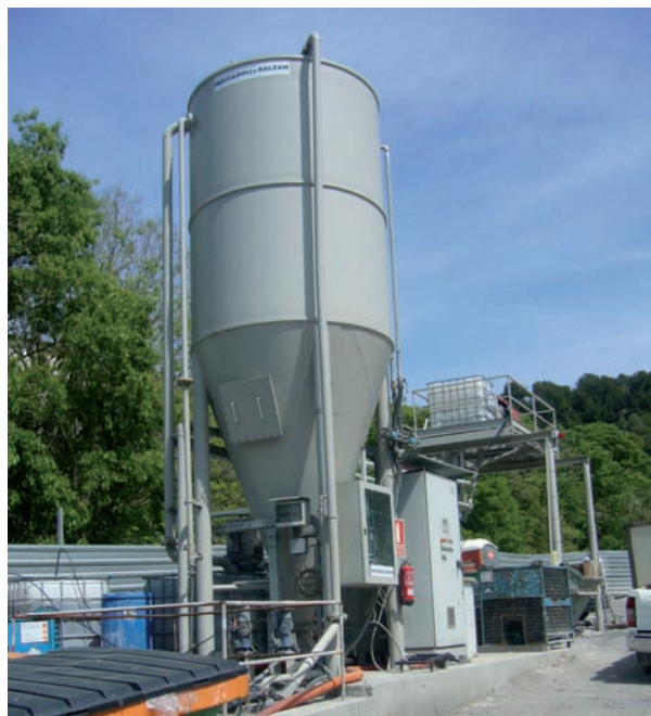
Las instalaciones de depuración de nuestras obras tienen que ser capaces de depurar adecuadamente los efluentes producidos, controlando parámetros como aceites y grasas, sólidos en suspensión y pH, además de contener un vertido hipotético accidental.
