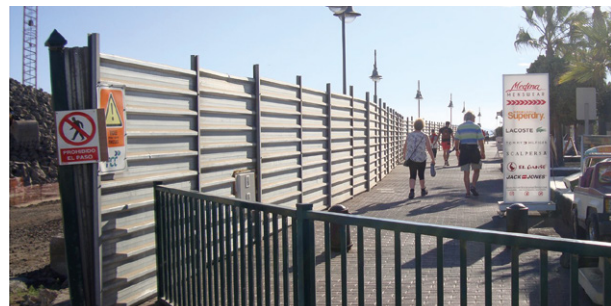
La valla de delimitación del perímetro de la obra actúa como panel acústico.
