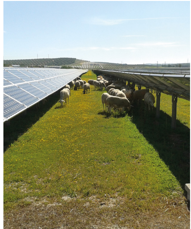
El pastoreo en los terrenos de las instalaciones de las plantas solares fotovoltaicas ubicadas en Espejo controla el crecimiento de la vegetación herbácea y reduce el riesgo de incendios.
