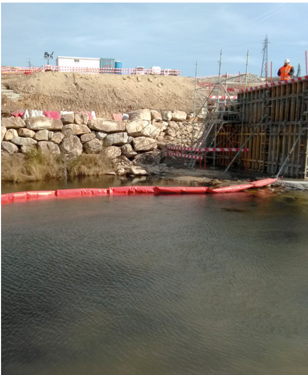
La barrera de geotextil retiene partículas en suspensión alrededor de la zona de obra.
