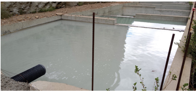
El uso de balsas de decantación permite controlar los sólidos en suspensión del agua en los vertidos de efluentes y aguas de proceso.
