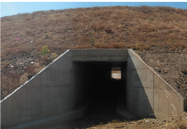
Obra de drenaje transversal habilitado como paso de fauna.
