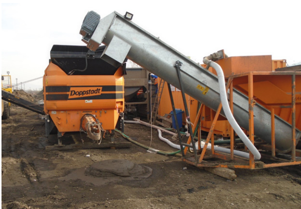
Con la máquina Trommel Screening Machine Doppstadt SM 620 se genera un circuito cerrado para descontaminar el balasto que permite reutilizar el agua empleada y eliminar convenientemente los residuos.
