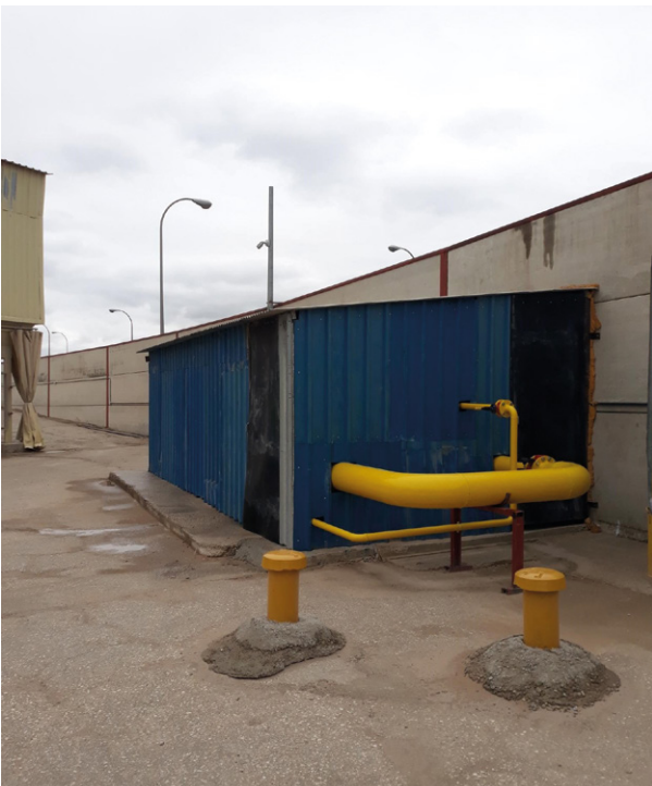
Tuberías de suministro de gas natural en la planta de fabricación de aglomerado de Vicálvaro.
