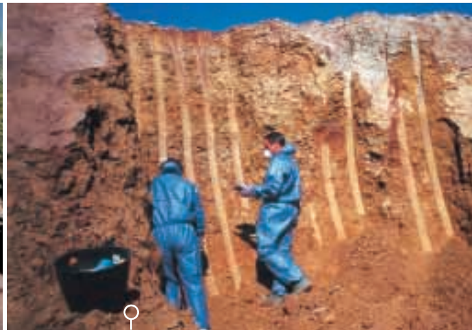
PLANTA MÓVIL para la recuperación de acuíferos, izquierda. A la derecha, desarrollo de una caracterización de suelos.
